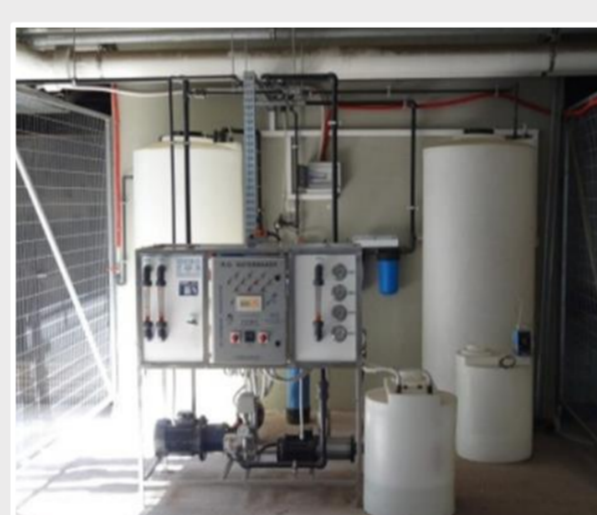
Μονάδα αφαλάτωσης αντίστροφης ώσμωσης
